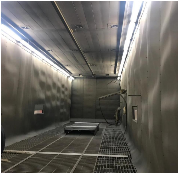
Figura 10: Gabinete de jato de granalha empresa B Fonte: O autor (2018)
