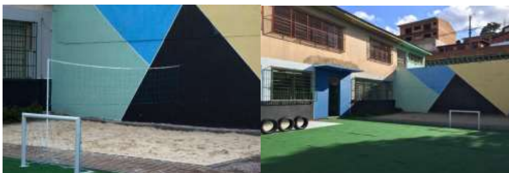
Figuras 8 e 9 - Fotos antes e depois da quadra de vôlei. Fonte: Autores.
